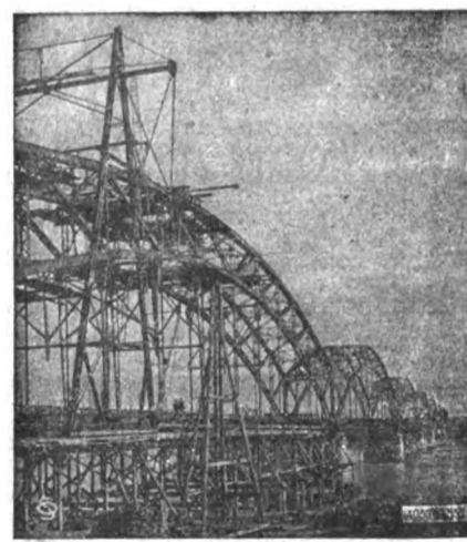
Ponte sul PO alla Geròla (Voghera) lung. m. 751,56. 8 arcate. Fondazioni ad aria compressa
