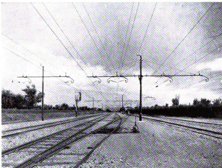
Linee di contatto del sistema a corrente continua in una stazione della linea Milano-Bologna (1938).
