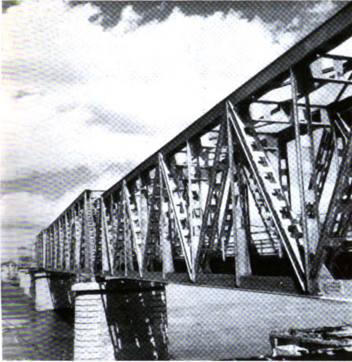
Ponte sul Po a Pontelagoscuro (linea Bologna-Padova) a 6 travate rettilinee indipendenti, di luce m 59,40 le due estreme e m 75,60 le quattro centrali, con travi maestre a grandi maglie triangolari, a passaggio inferiore, superiormente chiuse.
