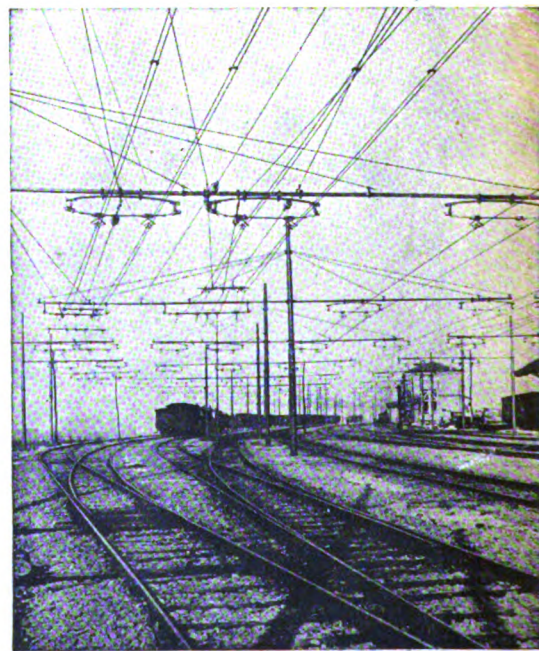
Stazione di Fornovo-Taro condutture di contatto
