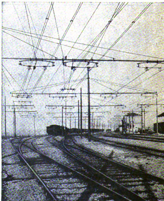
Stazione di Fornovo-Taro condutture di contatto LAVORI DI ELETTRIFICAZIONE DELLA LINEA PONTREMOLESE eseguiti dalla S. A. E. Soc. Anon. Elettrificazione
