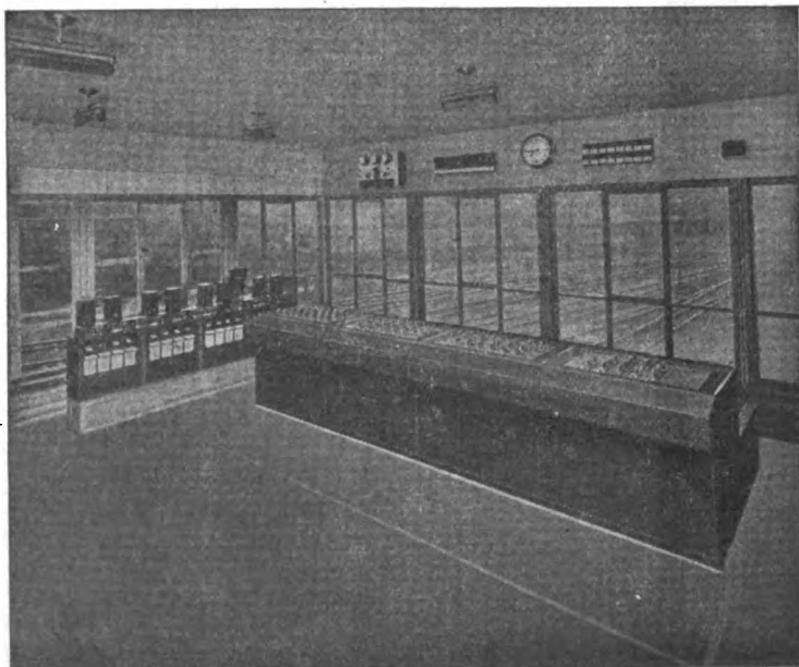
Apparato centrale elettrico e 4 ordini di leve per manovra scambi e segnali
