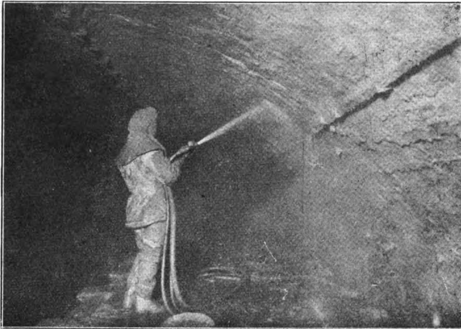
FIG. 8. — Ferrovia Domodossola-Iselle: Applicazione dell'intonaco impermeabilizzante con apparecchio Cement-Gun. I tre tubi innestati alla lancia adducono rispettivamente miscela di sabbia e cemento asciutto, acqua e liquido idrofugo.
