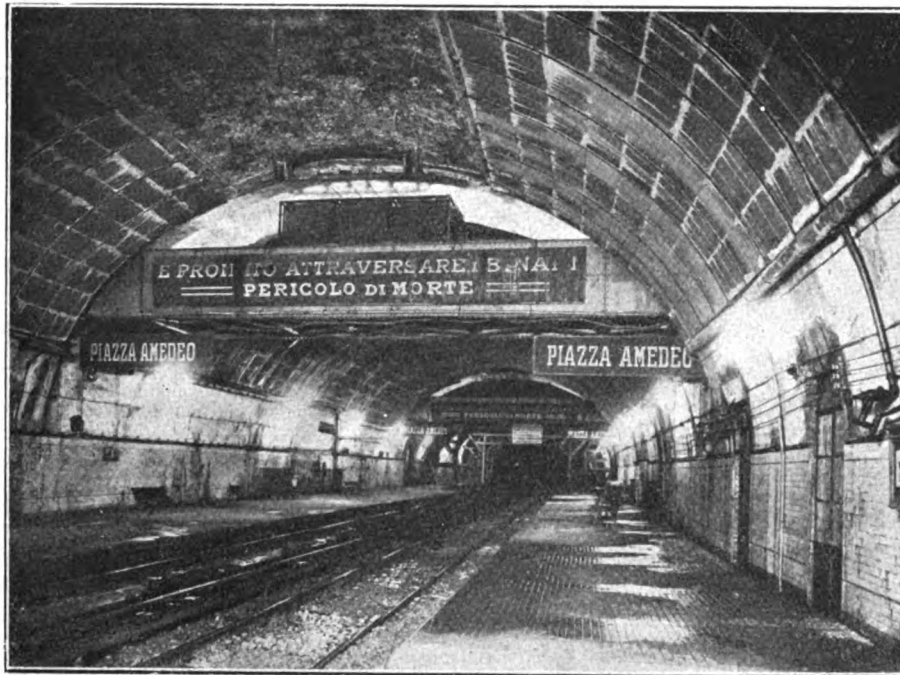
FIG. 1. — Direttissima Roma-Napoli. Fermata sotterranea di Piazza Amedeo in Napoli: Le condizioni della fermata prima dell'inizio dei lavori d'impermeabilizzazione. Si scorgono sulla volta le applicazioni di lastre di Eternit, i canali e le tubazioni per la raccolta delle acque. Dall'acqua stagnante sui marciapiedi si ha la prova dell'insufficienza dei ripari.
