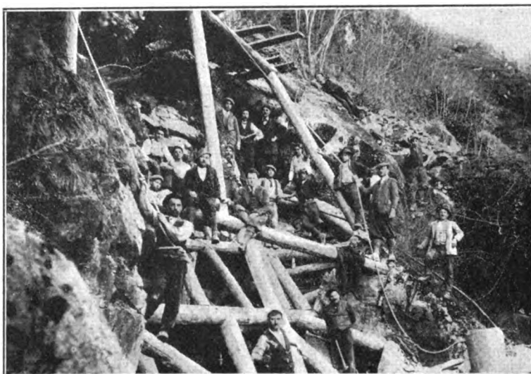
Fig. 13. — Galleria Barco: finestra apertasi durante i lavori di scavo.
