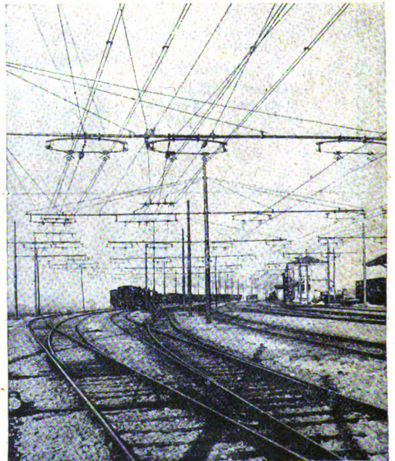
Stazione di Fornovo-Taro condutture di contatto
