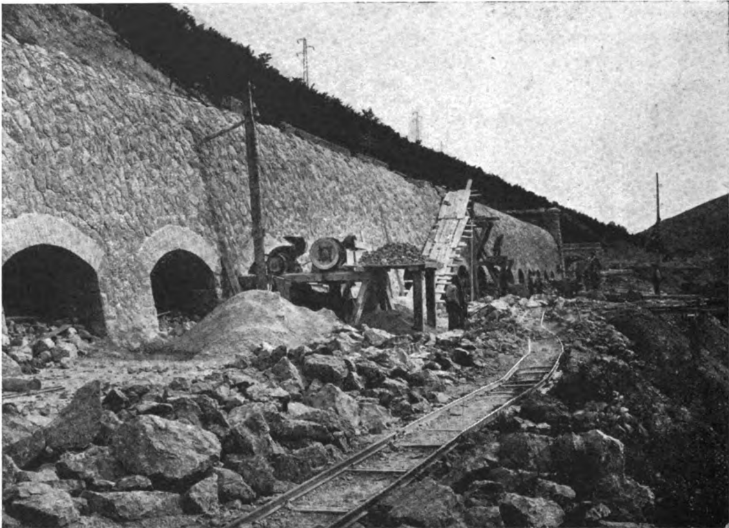
Fig. 0. - Galleria artificiale « Geronet Saltarelli » verso il Lago Morto.
