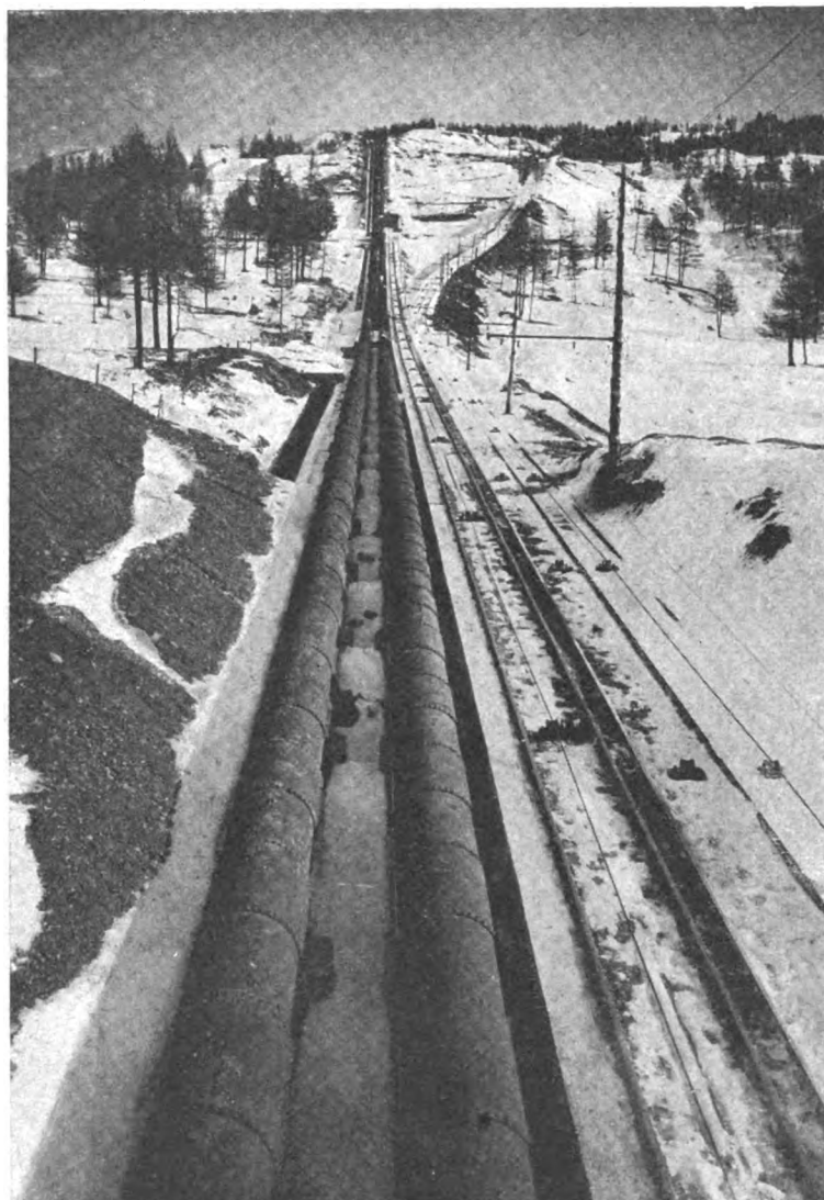
Fig. 11. — BARDONECCHIA - Condotte forzate del Rochemolles: piani inclinati (a destra), canale di scarico (a sinistra).
