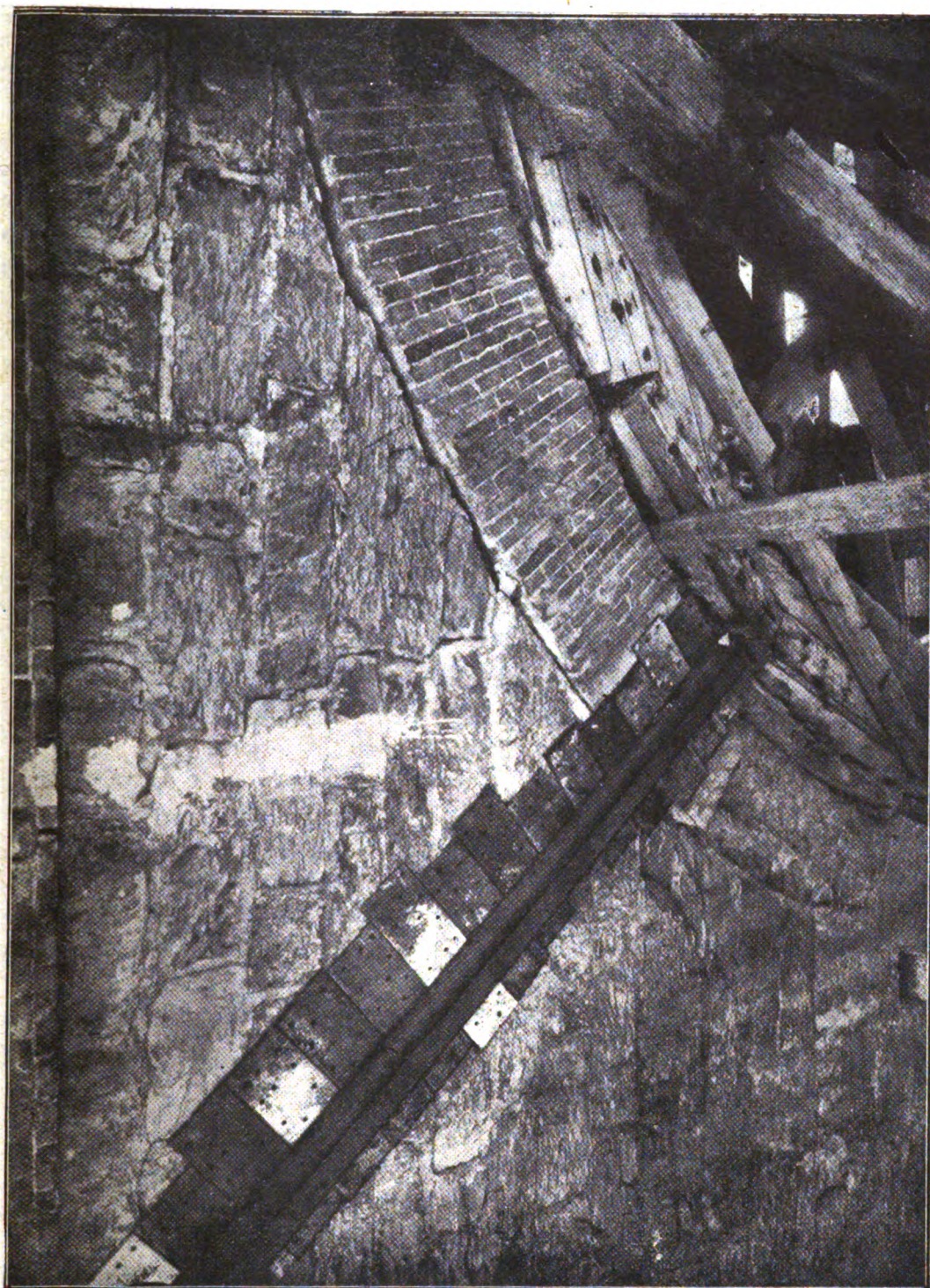
Fig. 7. - Lesioni e schiacciamento in corrispondenza dell'armilla a monte dell'arcata n. 15.
