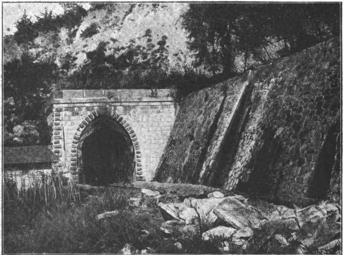
Fot. 6ª - PARTICOLARE DELL'IMBOCCO IVREA DELLA GALLERIA DI TERCY LESIONATO E ALQUANTO INCLINATO VERSO FIUME. ARMATURE IN LEGNO. SOVRASTANTE SCOSCENDIMENTO DEL MATERIALE MORENICO ALTERATO E FRANOSO (vedi Fot. n. 7).
