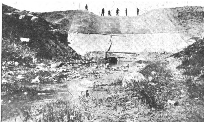
Fig. 5 — La diga veduta da valle durante la costruzione del mantello di calcestruzzo.
