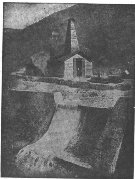
Impianto di una Sonda, B F a vapore, presso le Ferrovie dello Stato a Montepiano, per eseguire sondaggi sulla Direttissima Bologna-Firenze
