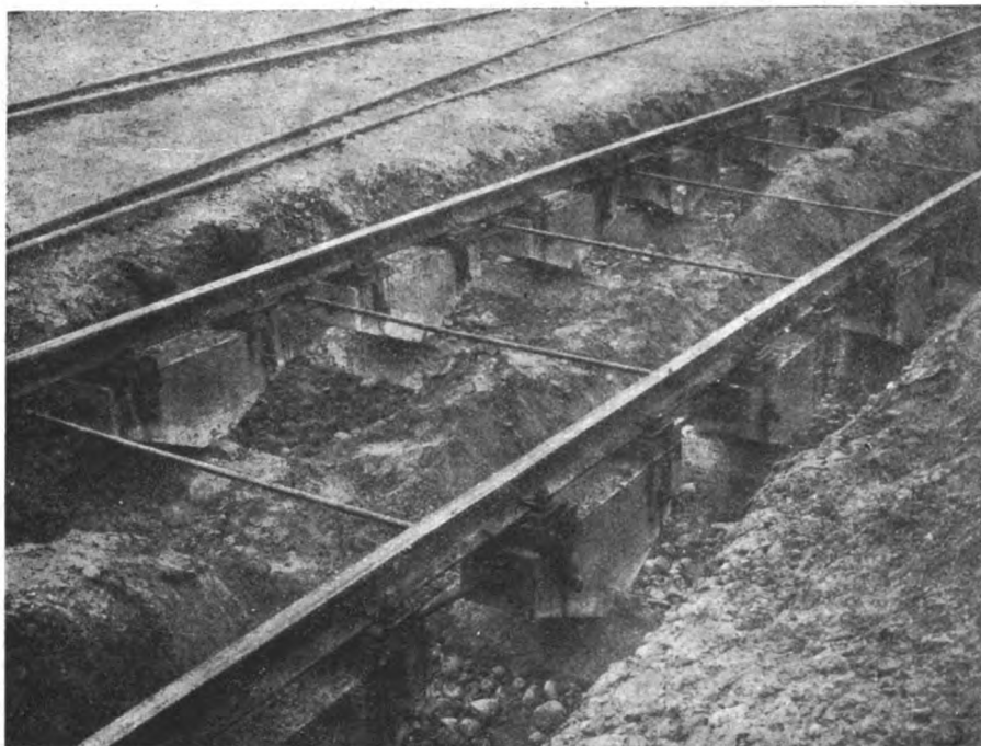
Fig. 6. — Impianto della linea secondaria di Asti.
