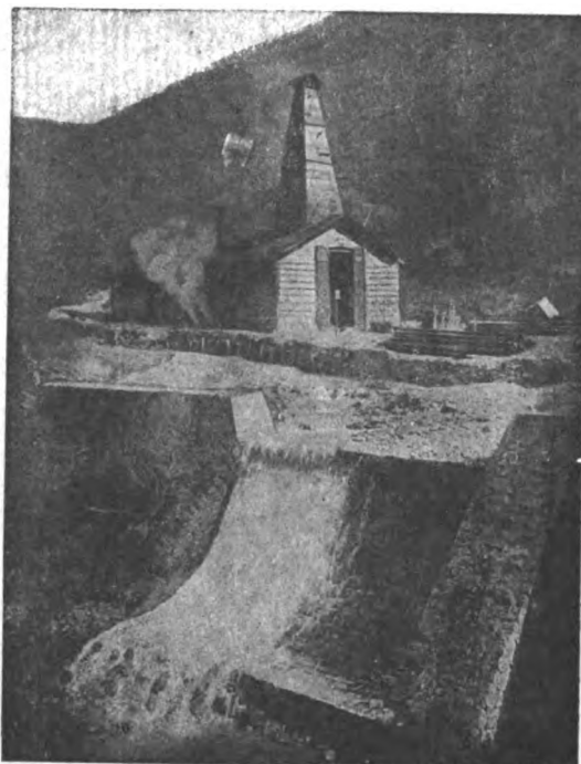
Impianto di una Sonda B F a vapore, presso le Ferrovie dello Stato a Montepiano, per eseguire sondaggi sulla Direttissima Bologna-Firenze
