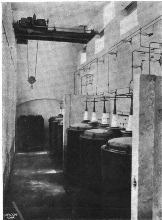
r) Sala dei trasformatori monofasi 500 K.V.A. 16 periodi 3700/55000 Volts.
