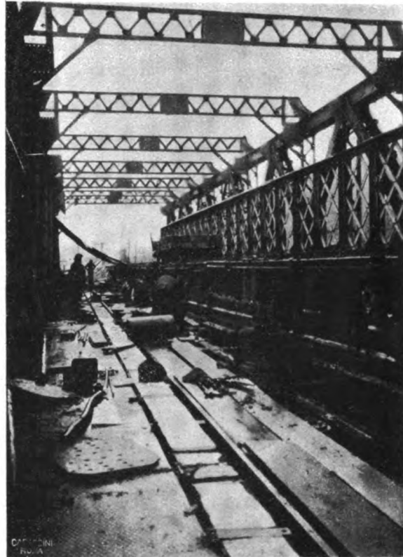
Durante la posizione in opera delle longarine a valle del binario a monte, dopo asportata la trave principale a monte della vecchia travata.
